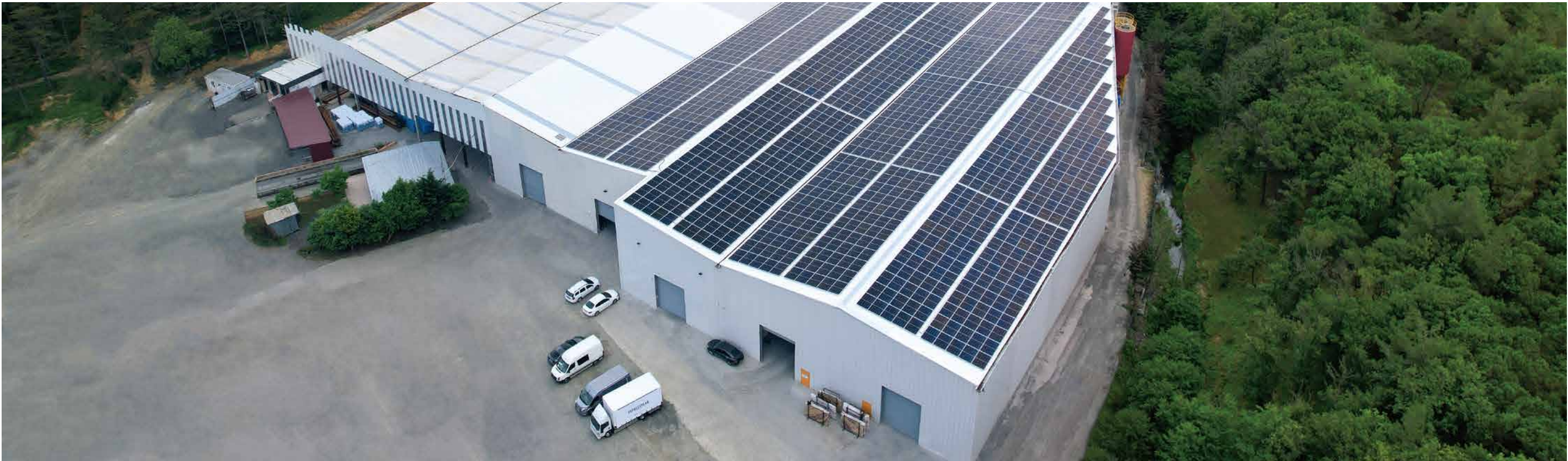
04 Riduzione dei Costi Energetici per la Fabbrica di Acqua Minerale Turchia, 900kW KSG-120CL-M0
